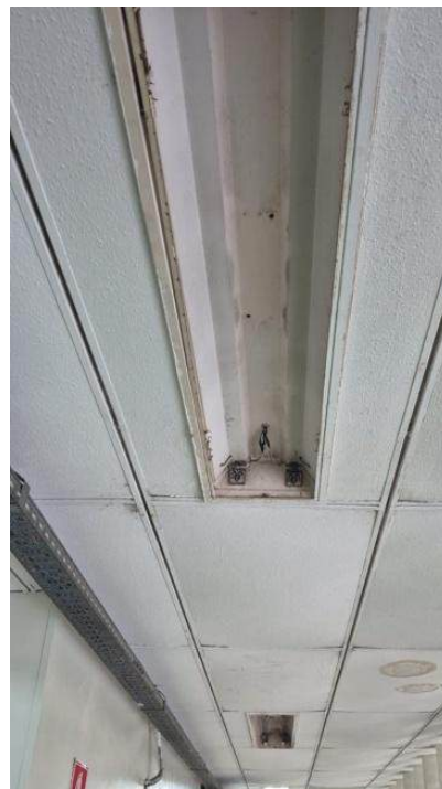
Falta de luminárias e Condensadores expostos no quarto andar
