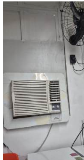
Ar condicionado e ventilador na copa do terceiro, devido ao calor, e ainda assim não dá conta.
