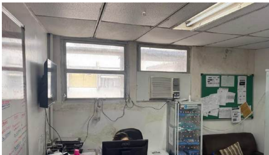
217 - sala de atendimento da enfermagem com mofo
