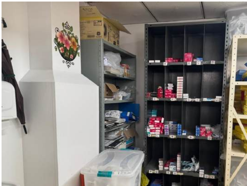
SI 217 - sala de atendimento da enfermagem com mofo
