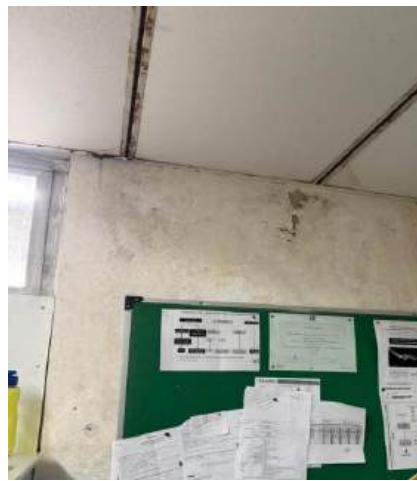
SI 217 - sala de atendimento da enfermagem com mofo
