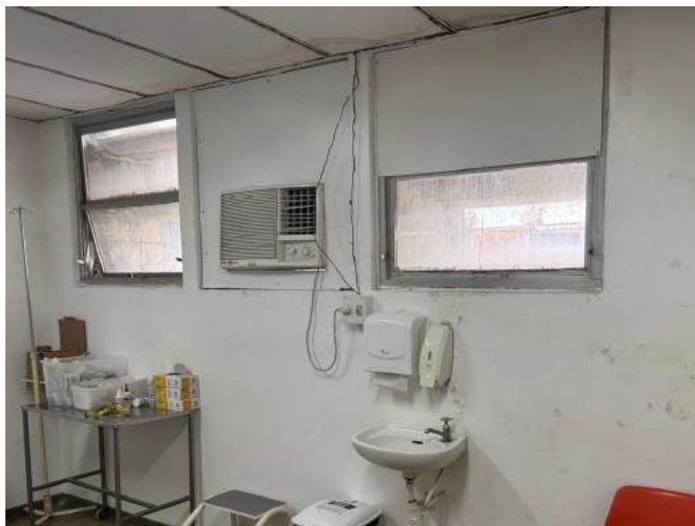
SI 218 consultório parede com mofo e ninho de pombos na caixa do ar condicionado, janelas que não fecham
