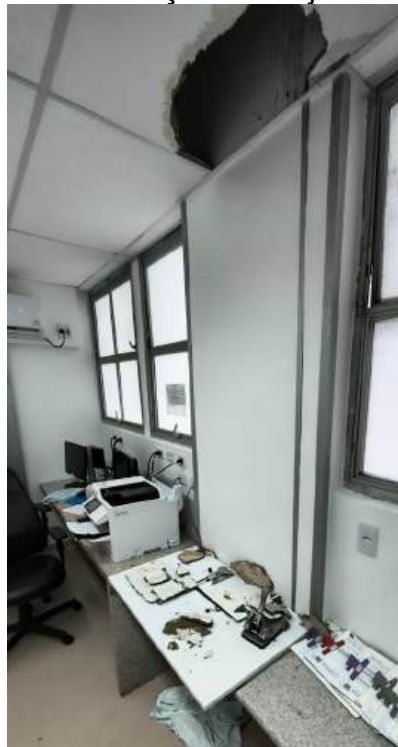
Infiltrações na laje
