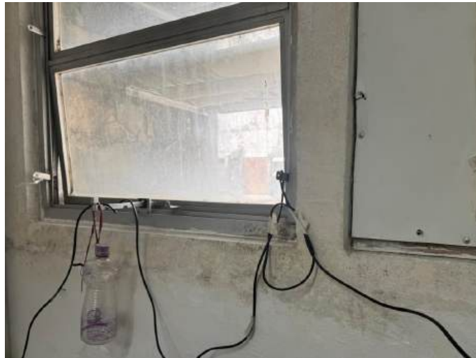
217 - sala de atendimento da enfermagem com mofo
