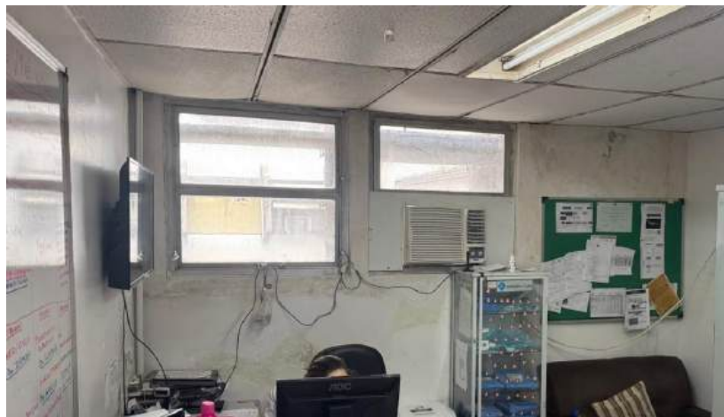
217 - sala de atendimento da enfermagem com mofo
