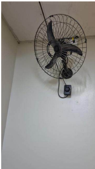
Ventilador quebrado, sem manutenção
