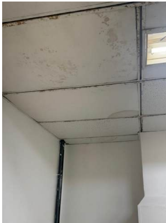
Sala com vazamento no teto 219
