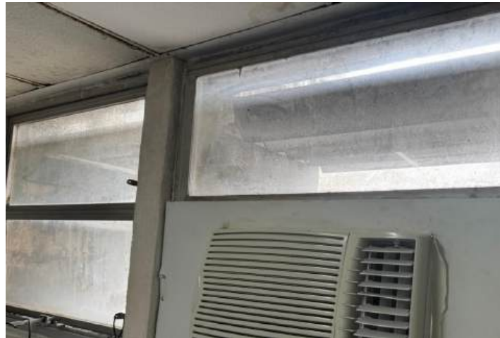
Sala com vazamento no teto 219
