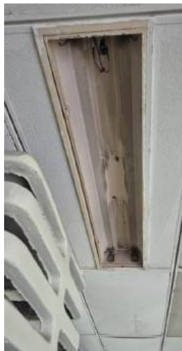
Painel não funciona no quarto andar
